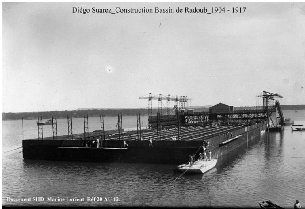
Photo 22 : Construction à flot des caissons latéraux et des bajoyers (Archives SHD Lorient)
